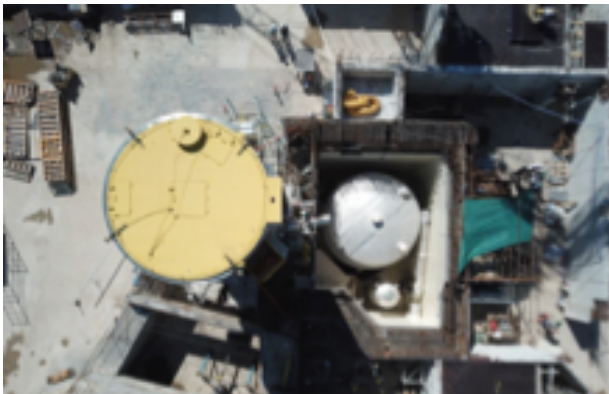
Ilustración 4. De izquierda a derecha: pileta principal del reactor y tanque de decaimiento.
