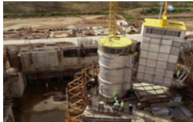
Ilustración 5. De izquierda a derecha: pileta principal del reactor y colocación de pileta de servicios.
